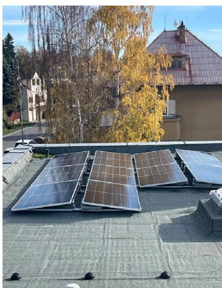
FVE na budově bazénu a MŠ V Parku
