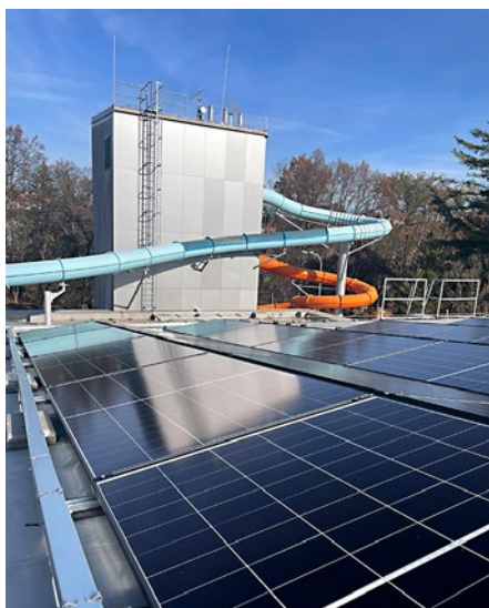
FVE na budově bazénu a MŠ V Parku
